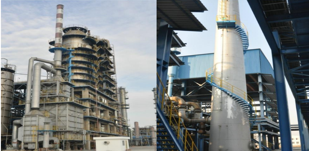
加热炉烟气排气筒及监测平台
