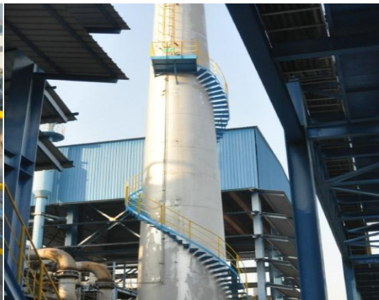
催化剂再生废气排气筒平台
