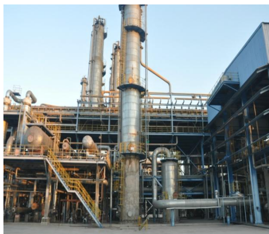
再生烟气排气筒
