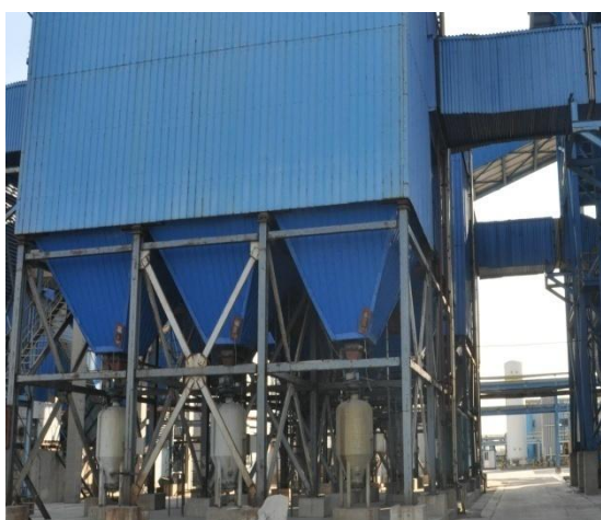
布袋除尘设施
