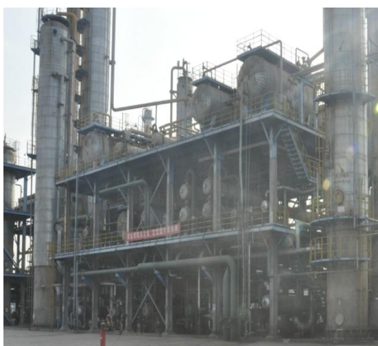
醚化罐和换热器
