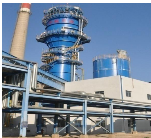
超低脱硫湿电除尘设施
