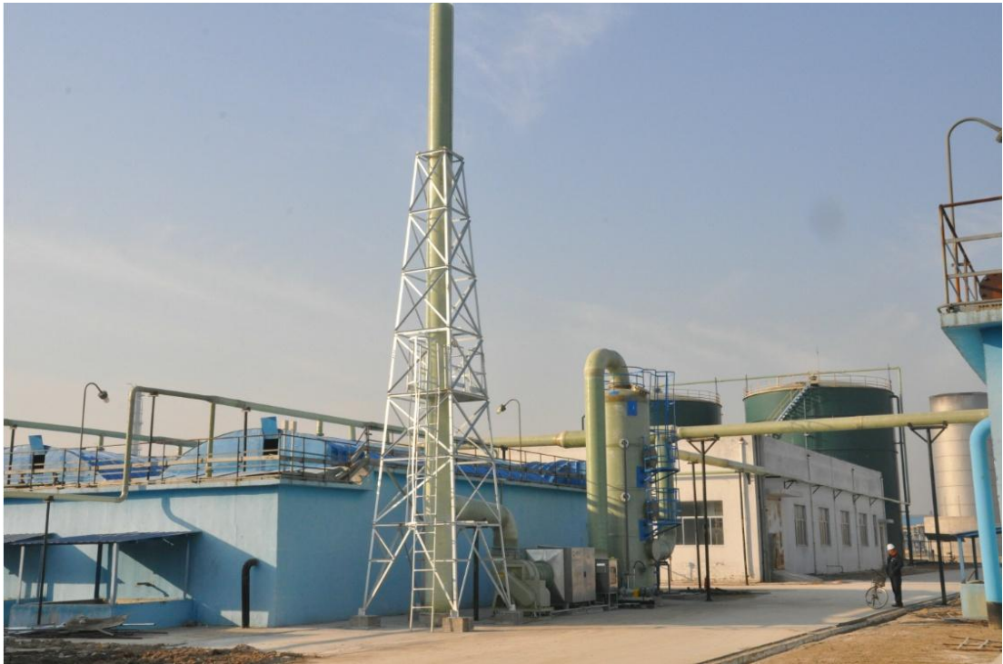
污水处理站恶臭气体处理设施
