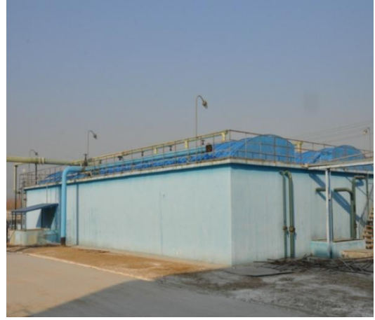
污水处理组合水池二
