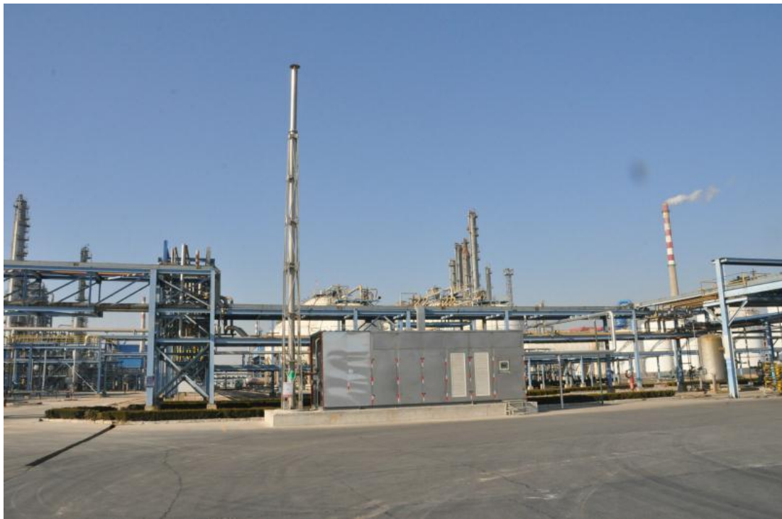
油气回收系统及废气排气筒
